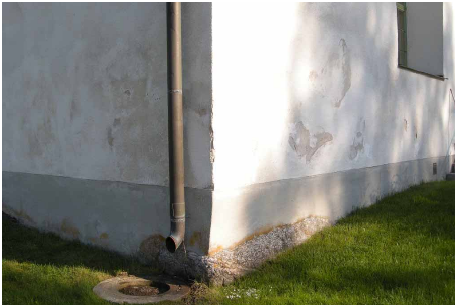
Figur 5. Detalj av färgbortfall och putssläpp vid kyrkobyggnadens nordvästra hörn. Foto från nordväst, Daniel Olsson, Länsmuseet Gävleborg 2012-05-22.
