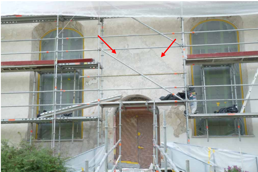
Figur 15. Spår efter det tidigare vapenhusets tak på kyrkans västra fasad, se röda pilar inlagda i bilden. Foto: Bjuråker-Norrbo församling sommaren 2012.
