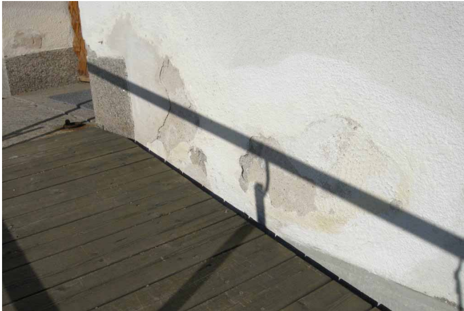
Figur 4. Detalj av putsskador intill rampen vid kyrkans västra fasad. Foto från sydväst, Daniel Olsson, Länsmuseet Gävleborg 2012-05-22.
