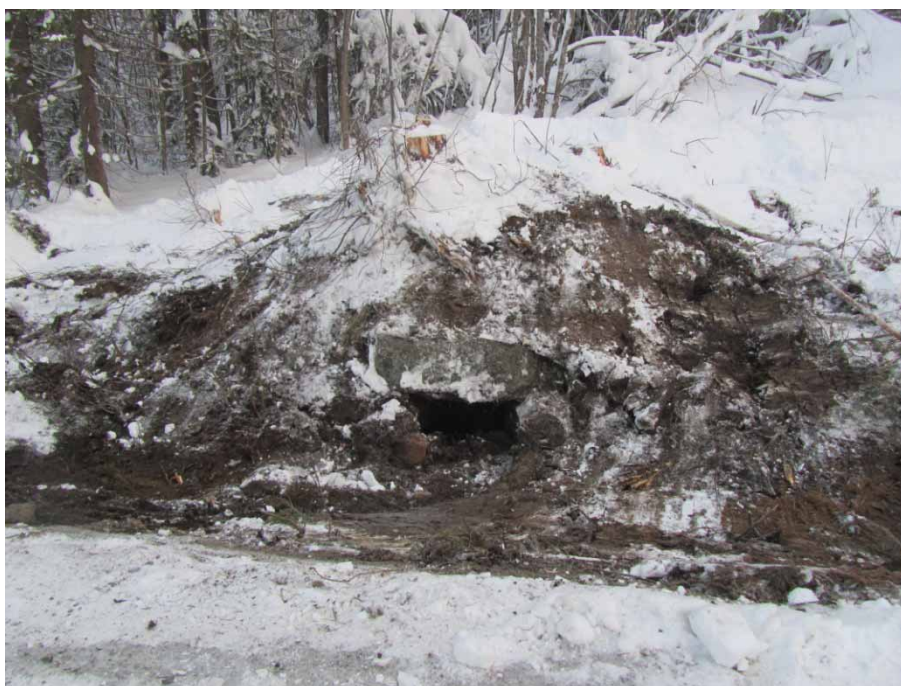
Figur 5. Jordkällaren inom bebyggelselämningen Majas vid schaktningsarbetet. Foto från söder. Foto: Inga Blennå.
