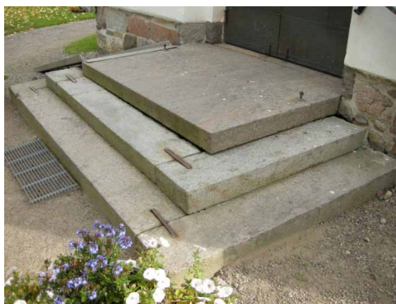
Ill. 4. Detalj av stentrappan från sydväst före ombyggnaden. Foto: Daniel Olsson, Länsmuseet Gävleborg 2008-09-26.
