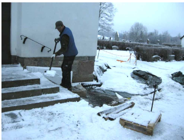
Ill. 5. Åke Fredriksson från Åkes bygg skottar bort snö från stentrappan. I bakgrunden ses urgrävningen som utförts för rampens grundläggning, här täckt med presenningar. Foto från nordväst, Daniel Olsson, Läns museet Gävleborg 2008-12-05.
