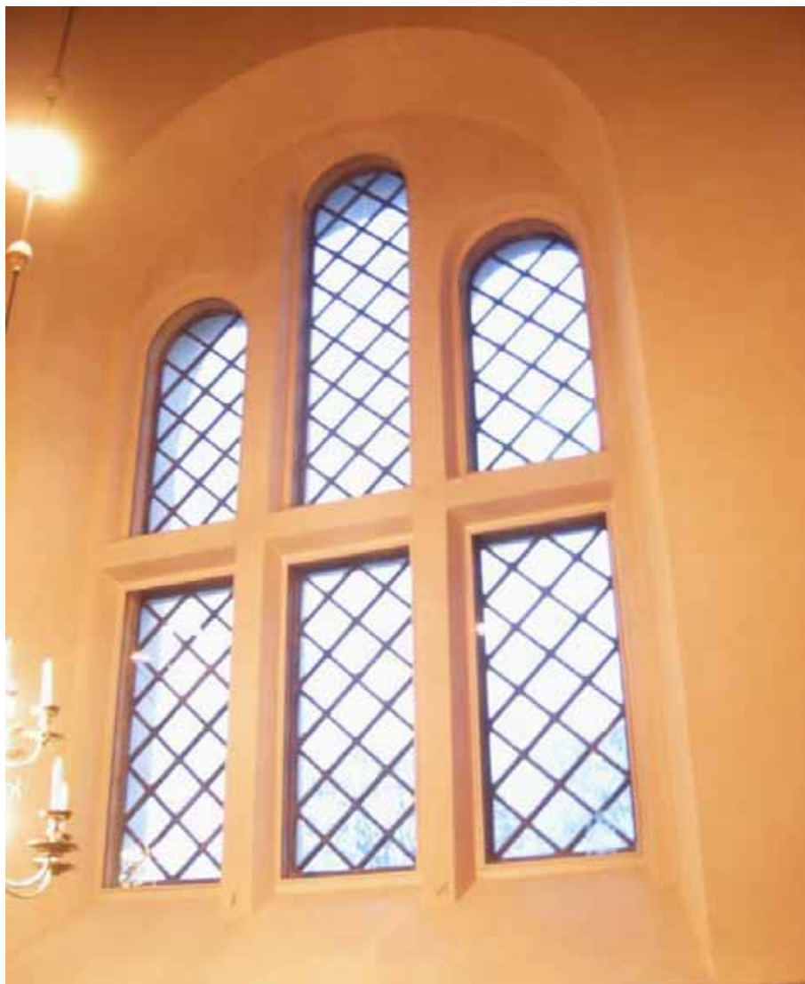
Figur 14. Fönsterparti i kyrkorummet efter avslutad installation av isolerrutor. Foto: Daniel Olsson, Länsmuseet Gävleborg 2013-10-31.
