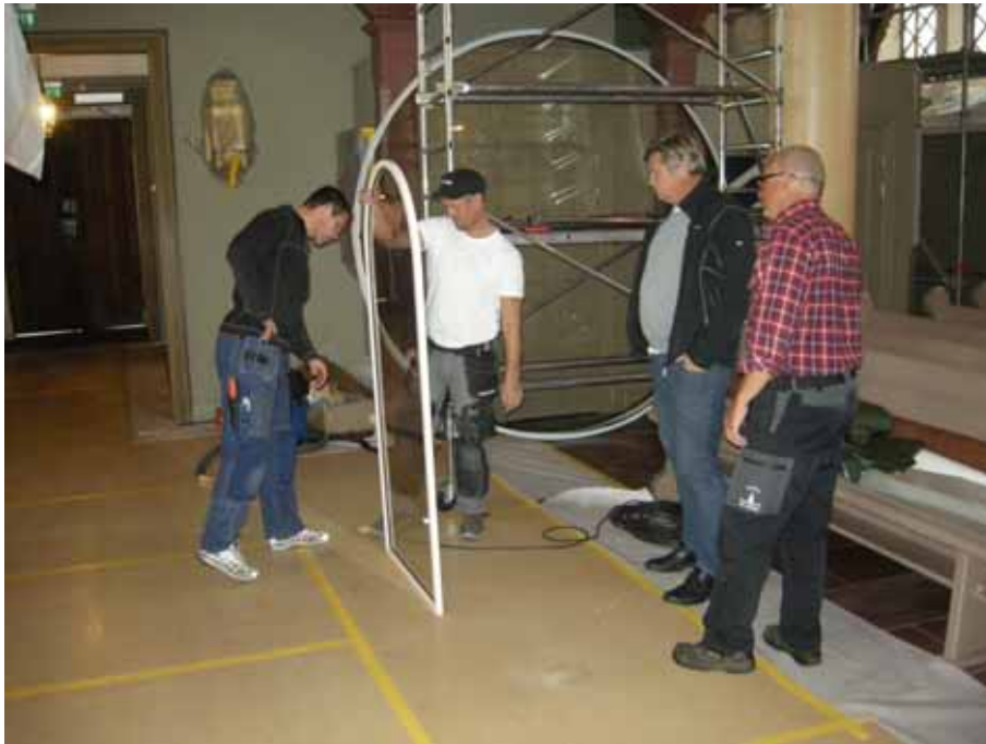
Figur 15. En monterad isolerruta studeras innan installation vid byggmöte i kyrkan under arbetet. I bakgrunden ett av rosettönstrens stora isolerglas. Foto från sydöst: Daniel Olsson, Läns museet Gävleborg 2013-10-01.
