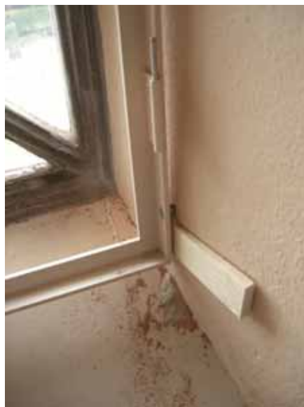
Figur 9. Detalj av aluminiumkarmens fastsättning i fönsternischen. Träkilen är bara ditsatt tillfälligt under installationen. Foto från nordöst, Daniel Olsson, Läns museet Gävleborg 2013-10-01.
