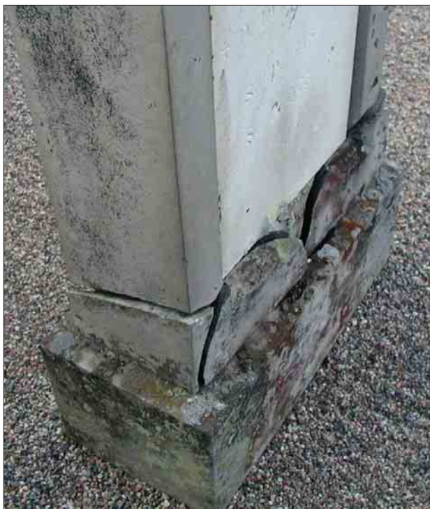
Bild 8. Sprickor på grund av rostande järndubb.
