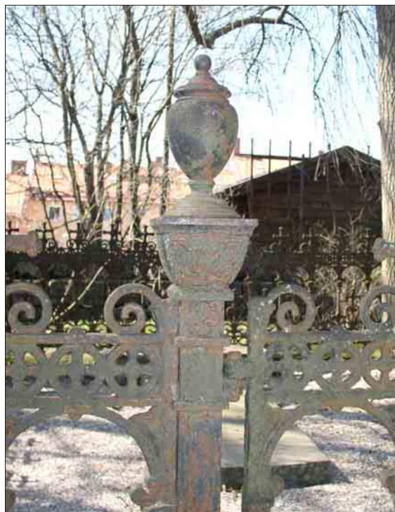
Bild 9. Rostigt gjutjärn i behov av underhåll.
