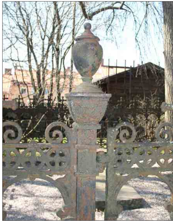
Bild 9. Rostigt gjutjärn i behov av underhåll.
