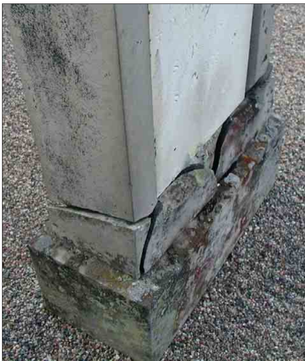
Bild 8. Sprickor på grund av rostande järndubb.
