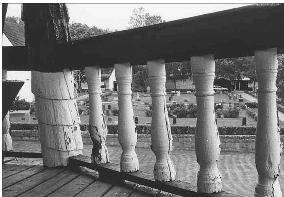
Bild 7. Klockstapelns balusterdockor före åtgärd. Foto Läns museet Gävleborg 2000.
