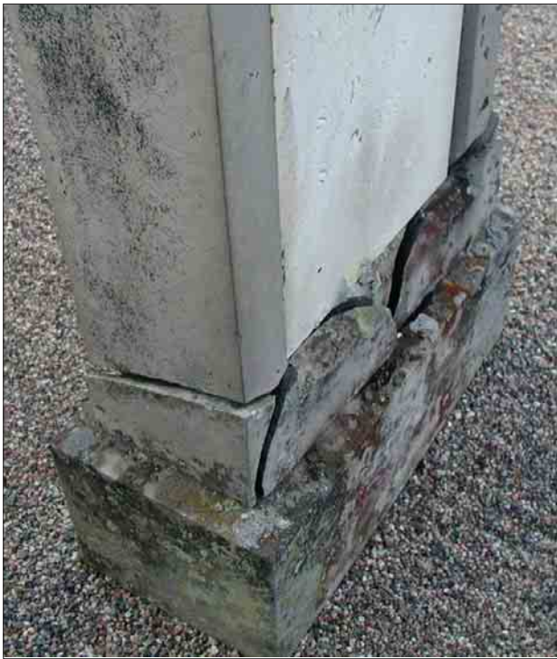
Bild 8. Sprickor på grund av rostande järndubb.
