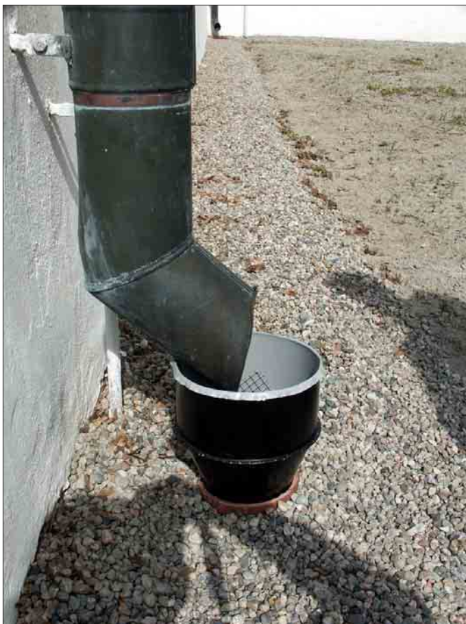
Bild 7. Stuprör med vattenuppsamlare. Vattensamlaren leder vattnet som kastas ut från stupröret ned i dräneringsbrunnen. Vattensamlaren motverkar att vatten rinner ut på marken vilket i sin tur kan orsaka att fasadputsens suger upp vattnet. Foto Henrik Lindblad. Dg 03-1609.
