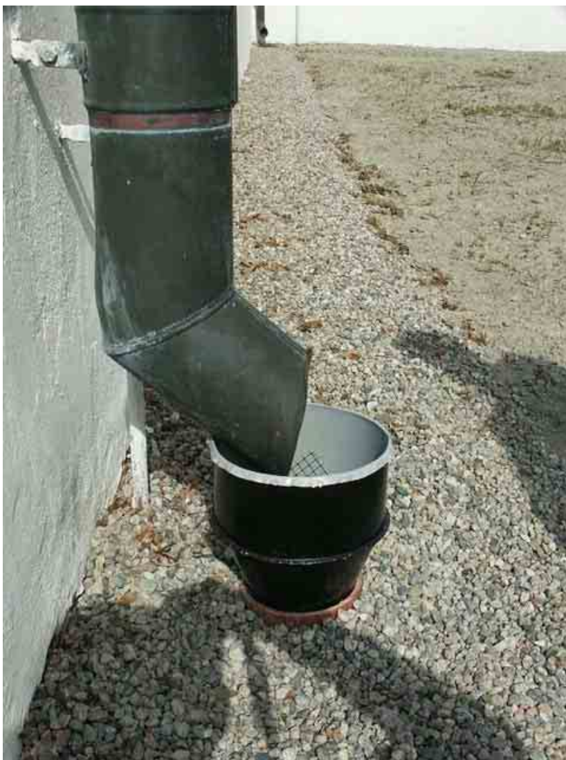
Skogs kyrka, sydvästra hörnet. Prov på vattenuppsamlare.
