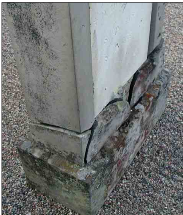
Bild 8. Sprickor på grund av rostande järndubb.
