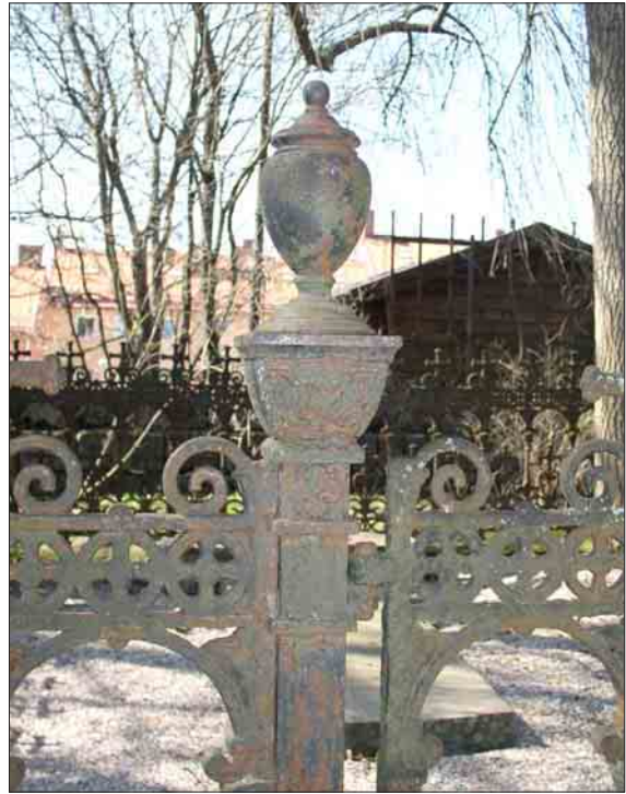
Bild 9. Rostigt gjutjärn i behov av underhåll.
