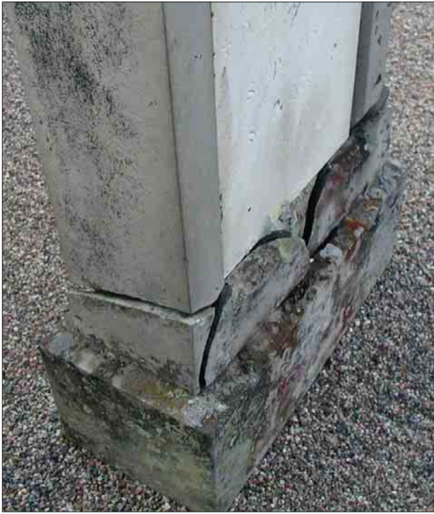
Bild 8. Sprickor på grund av rostande järndubb.
