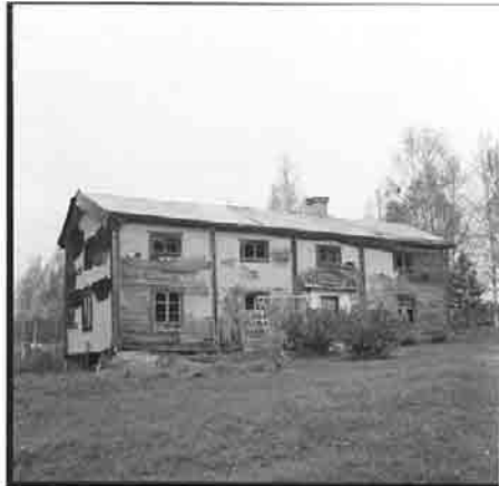
Framsida. Taket är täckt med pressenning. Neg nr K 99-855
