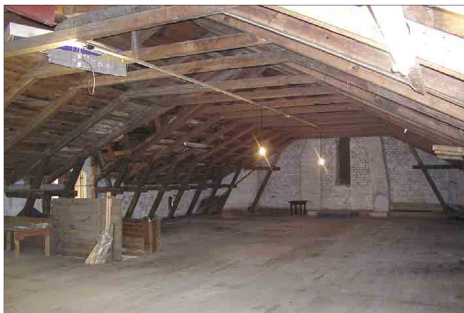
Bild 14. Vinden med den öppna takkonstruktionen. Foto L. Boox Läns museet Gävleborg. Dg 04-5165.
