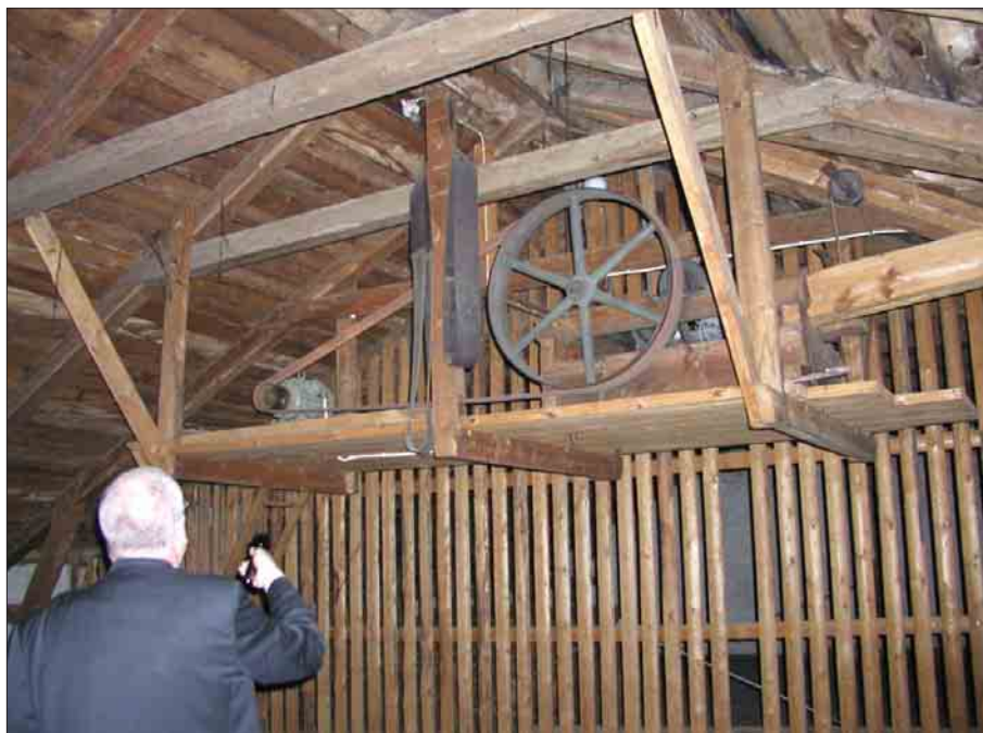
Bild 29. På plan 4 finns en äldre hissmotor kvar. Foto L. Boox. Länsmuseum Gävleborg. Dg 05-0425.
