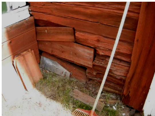
Ill. 7. Detalj av äldre instabil timmerlagning på den nordvästra fasaden söder om brokvisten. Foto från väster, Daniel Olsson, Läns-museet Gävleborg, 2009-06-29.
