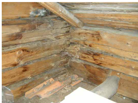
Ill. 5. Detalj av rötskadad knut på vinden. Foto från öster, Daniel Olsson, Länsmuseet Gävleborg, 2009-06-29.
