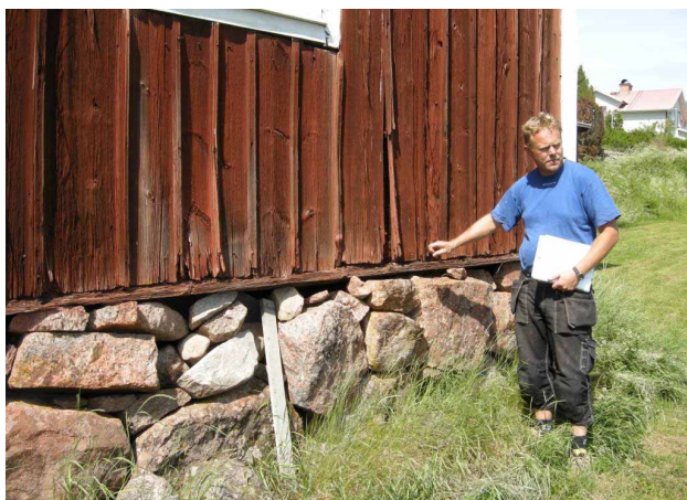
Ill. 6. Magnus Wallin vid byggnadens nordöstra gavel med vittrad och sprucken panel samt ojäm naturstensgrund. Foto från öster, Daniel Olsson, Länsmuseet Gävleborg, 2009-06-29.
