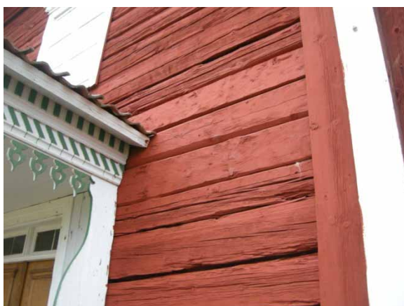
Ill. 10. Detalj av fasad mot nordväst efter timmerlagningar. Foto: Daniel Olsson, Läns museet Gävleborg 2009-10-23.
