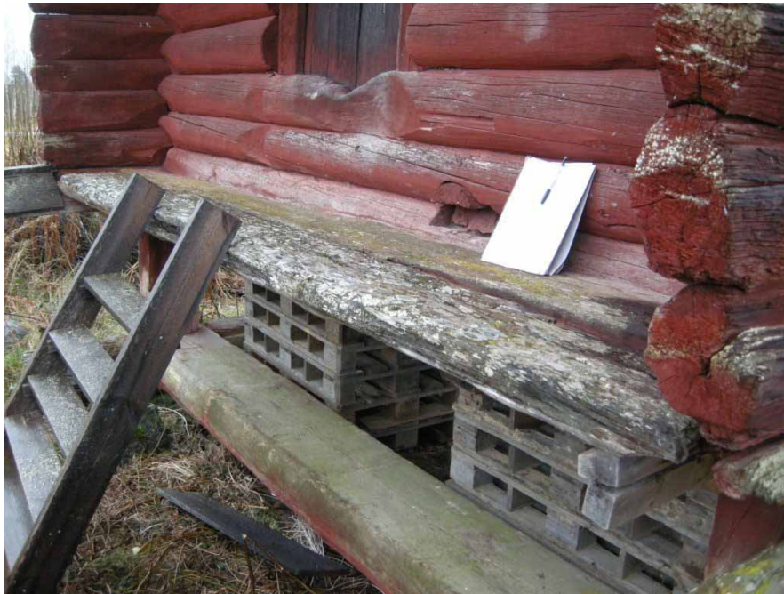
Ill. 7. Detalj från nordväst av svalens golv med den rötskadade yttersta golvbrädan. Foto: Daniel Olsson, Länsmuseet Gävleborg 2009-10-16.
