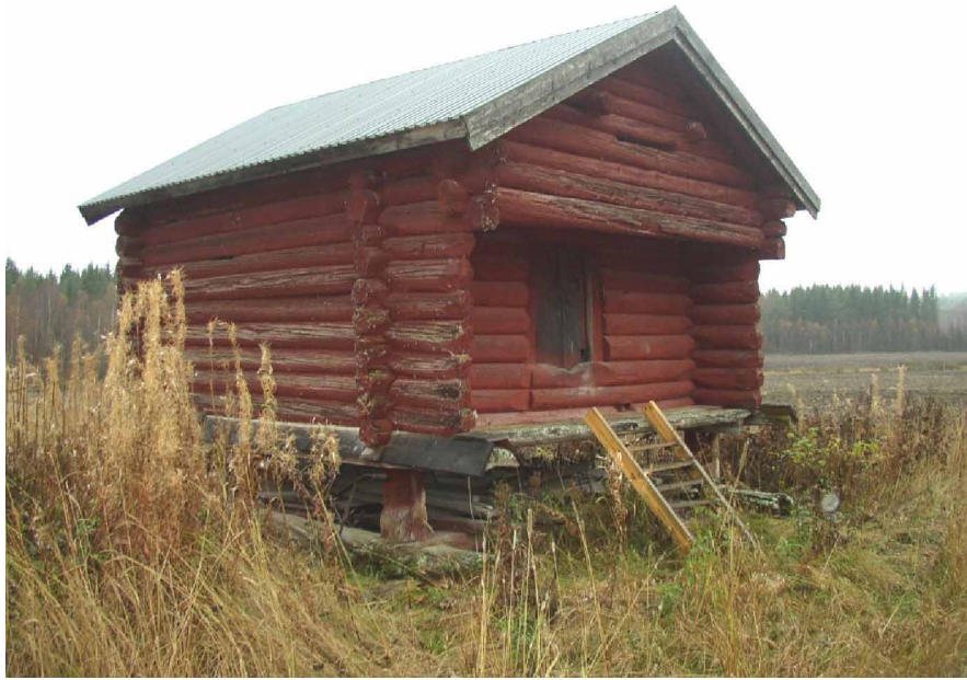
Ill. 1. Härbret från nordväst vid skadeinventeringen 2004. Foto: Daniel Olsson, Länsmuseet Gävleborg 2004-10-18.
