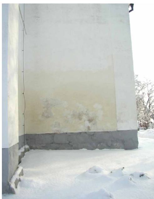
Ill. 6. Detalj av missfärgat parti på långhusets västra fasad söder om tornet. Foto från väster, Daniel Olsson, Läns museet Gävleborg 2007-02-09.
