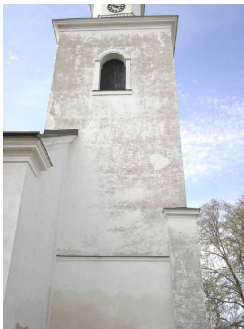
Ill. 5. Kyrktornets norra fasad med skadade kalkavfärgade partier. Foto: Urban Söderlund, Bergsjö kyrkliga samfällighet, maj 2009.
