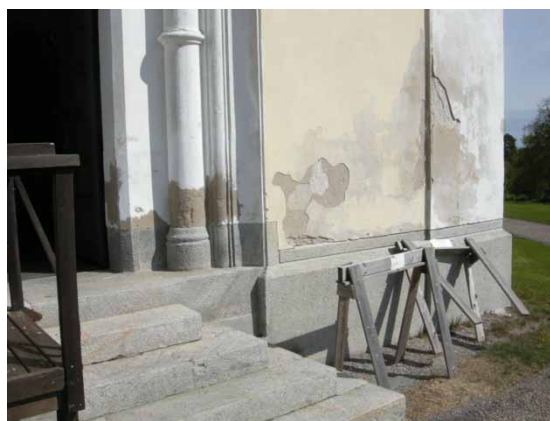
Ill. 12. Detalj av tornfasaden före renovering med bockar uppställda för att varna för rasrisk. Foto från sydväst, Daniel Olsson, Läns museet Gävleborg, 2009-07-07.
