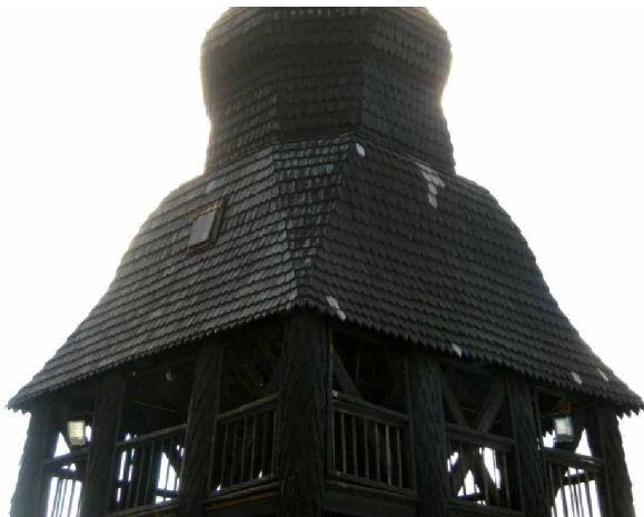
Ill. 5. Klockstapelns klockformade huv (takytorna upp till det vertikala partiet under lökkupolen) där spånen var rötskadade före renoveringen. På det vänstra takfallet ses den taklucka som beskrivs närmare i texten. Foto från nordost, Daniel Olsson, Länsmuseet Gävleborg 2010-04-13.
