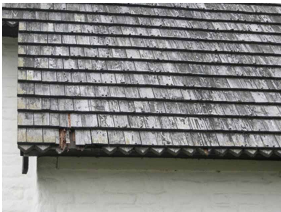
Figur 3. Detalj av det västra takfallets nedersta del med skadade takspån före takomläggningen. Foto: Daniel Olsson, Läns museet Gävleborg 2010-05-06.
