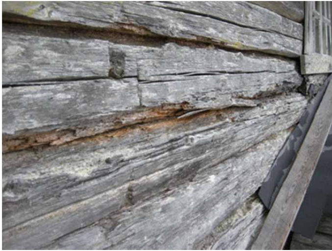
Figur 5. Rötffickor och rötskador i bodens nordöstra timmervägg. Foto från öster, Daniel Olsson, Läns museet Gävleborg 2009-10-29.
