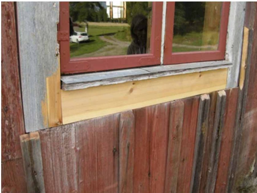
Figur 11. Detalj av fönster och fönsterfoder efter renovering. Foto: Daniel Olsson Läns museet Gävleborg 2009-09-03.
