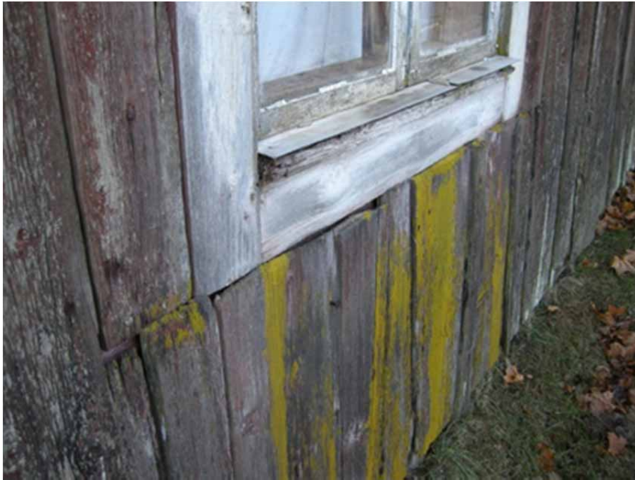
Figur 6. Detalj av panel, fönster och fönsterfoder på husets norra fasad. Foto från nordost, Daniel Olsson, Läns museet Gävleborg 2008-10-29.
