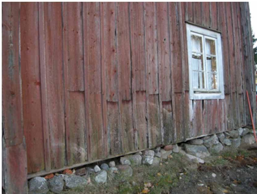
Figur 5. Detalj av skarvad panel och delvis nedrasad fyllnadsmur på den norra fasaden. Foto: Daniel Olsson, Läns museet Gävleborg 2008-10-29.
