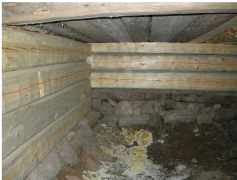
Figur 13. Den timrade källaren efter renovering. På marken syns svampangreppet som senare har sanerats. Foto: Daniel Olsson, Läns museet Gävleborg 2009-09-03.
