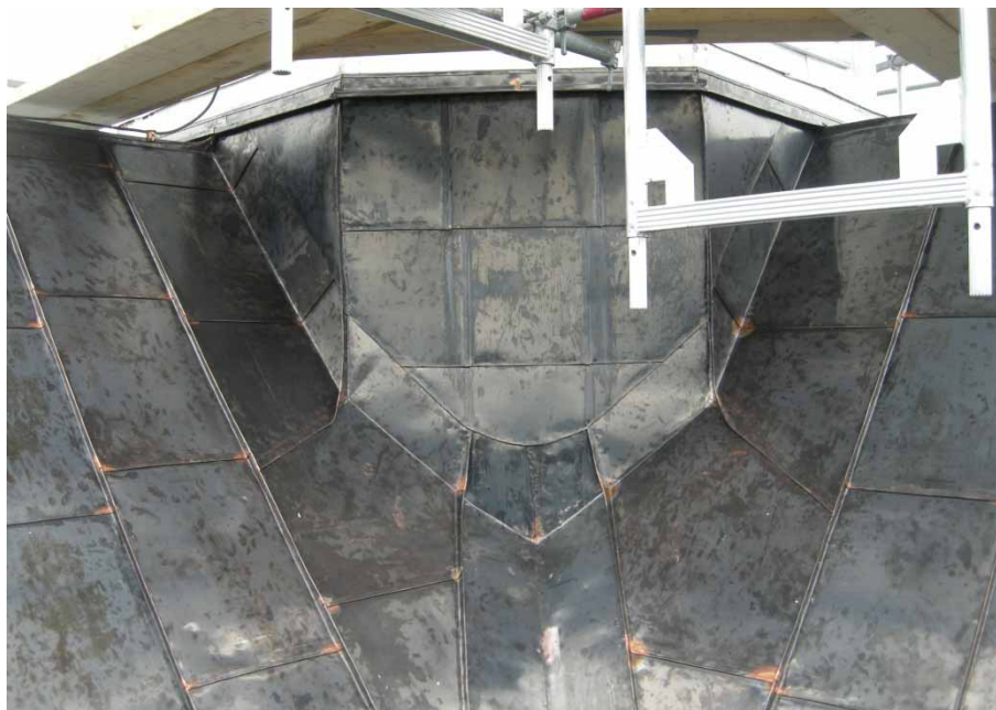
Figur 8. Detalj av torntaket efter omläggning med kopparplåt i mindre skivformat. Foto: Daniel Olsson, Länsmuseet Gävleborg 2013-07-10.
