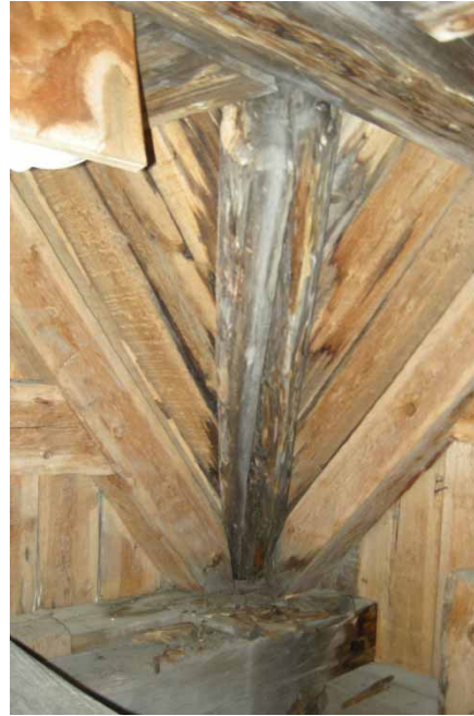
Figur 4. Detalj av rötskadad bärande ås i ett av de fyra hörnen inuti tornhuven. Foto: Daniel Olsson, Läns museet Gävleborg 2013-05-21.
