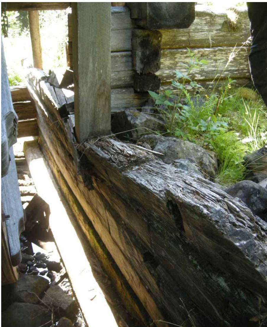
Figur 5. Detalj av hjulgravens södra sida med skadad timmerkonstruktion. Foto från norr, Daniel Olsson, Läns museet Gävleborg 2011-06-30.
