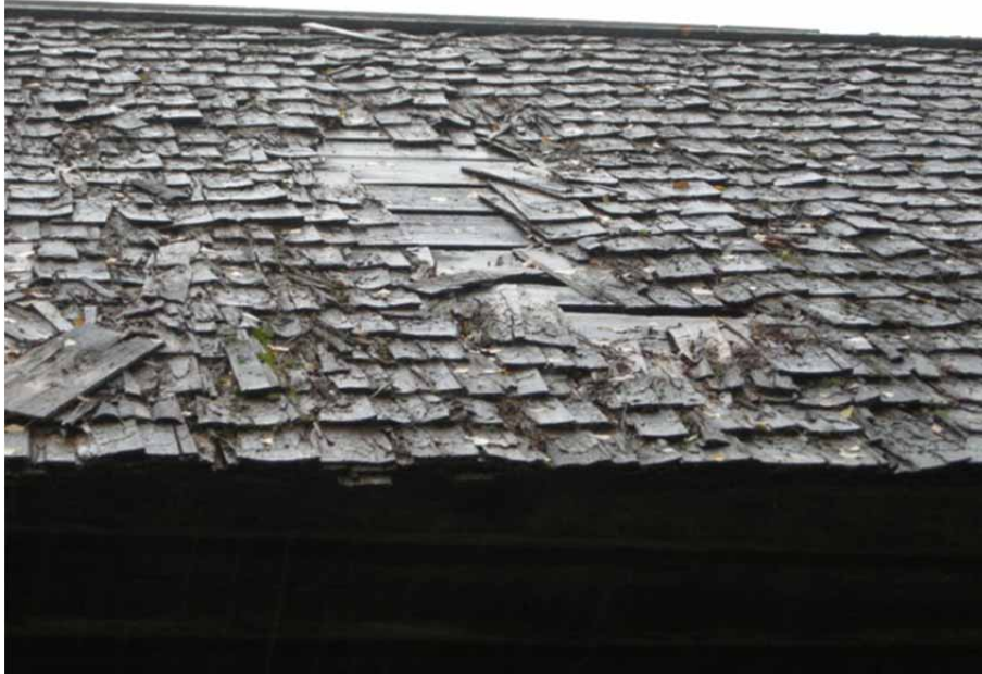
Figur 5. Sommarladugårdens takfall mot nordväst med ett stort parti där takspånen saknades helt. Foto från nordväst, Daniel Olsson, Läns museet Gävleborg 2014-10-08.
