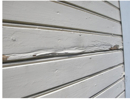
Figur 9. Detalj av rötskadad panelbräda i den östra fasaden. Foto från sydost, Daniel Olsson, Länsmuseum Gävleborg 2015-06-30.
