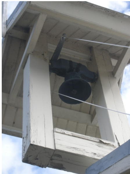
Figur 7. Detalj av klockstapeln med de rötskadade nedre trädelarna. Foto från sydväst, Daniel Olsson, Läns museet Gävleborg 2015-06-30.
