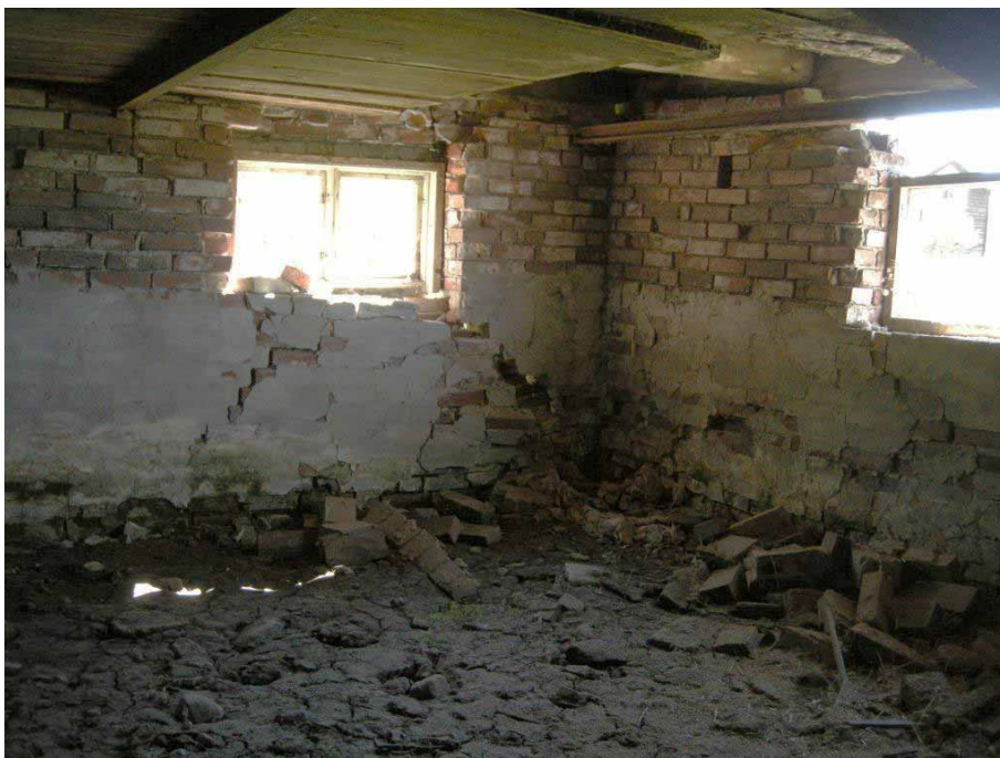
Figur 5. Detalj av gris- och hönshusets skadade tegelväggar. Foto från nordväst, Daniel Olsson, Läns museet Gävleborg 2009-06-30.
