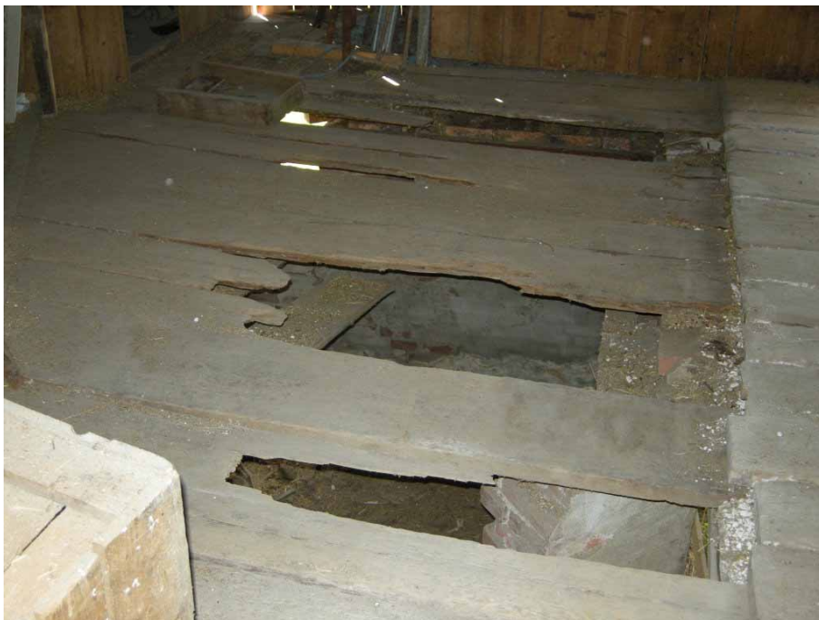
Figur 6. Detalj av skadat trägolv på andra våningsplanet i ladugårdsbyggnadens sydöstra del. Foto från norr, Daniel Olsson, Läns museet Gävleborg 2009-06-30.
