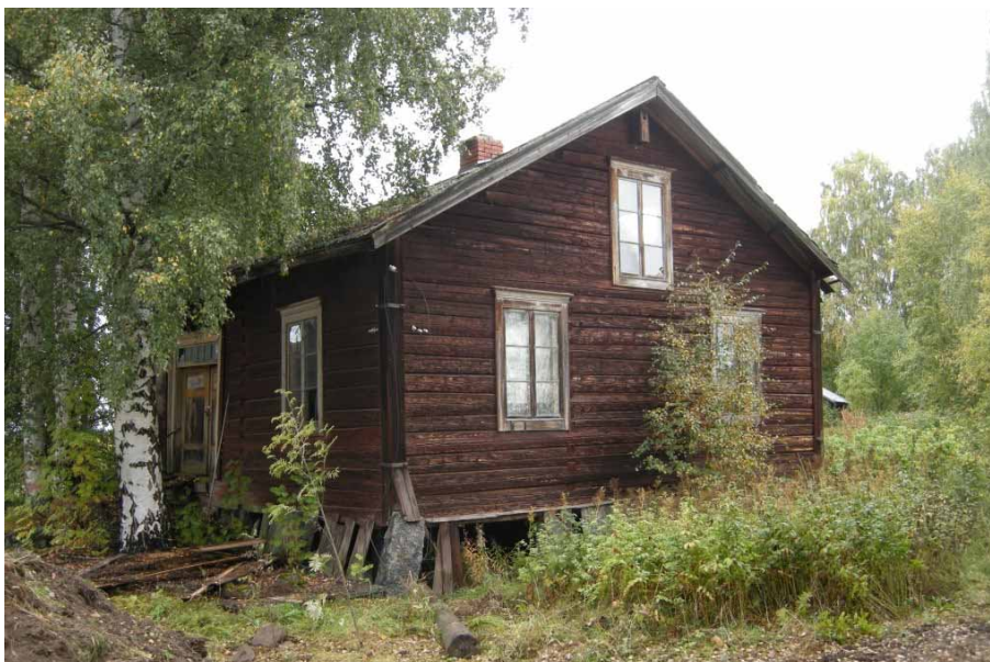
Figur 16. Den förfallna enkelstugan innan rivning. Foto från väster, Daniel Olsson, Läns museet Gävleborg 2013-09-18.
