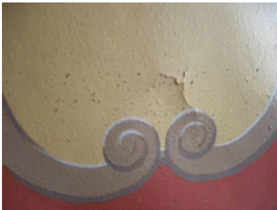
Figur 9. Hål efter pilkastning samt spricka i en av kaféets väggmålningar. Foto: Daniel Olsson, Läns museet Gävleborg 2014-02-12.
