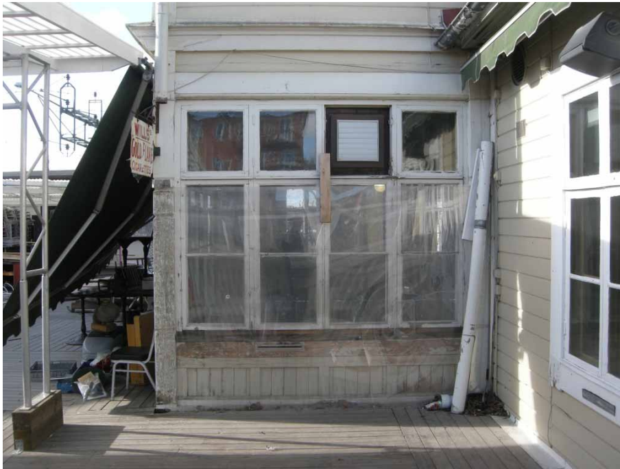
Figur 8. Glasverandans nordöstra del med rötskadat parti under fönstret. Foto från nordöst. Foto: Daniel Olsson, Läns museet Gävleborg 2014-04-03.
