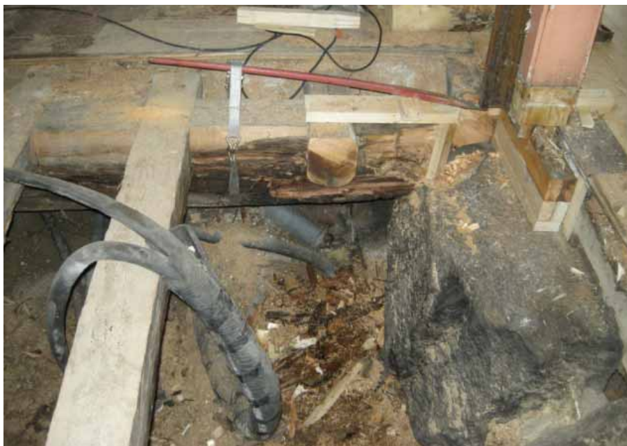
Figur 21. Detalj av rötskadan i bärande delar av golvkonstruktionen under bardisken i restaurangen. Foto från sydväst. Foto: Daniel Olsson, Läns museet Gävleborg 2014-04-03.
