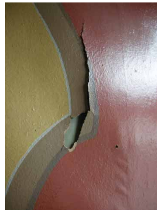
Figur 10. Detalj av spricka i en av kaféets väggmålningar. Foto: Daniel Olsson, Läns museet Gävleborg 2014-02-12.
