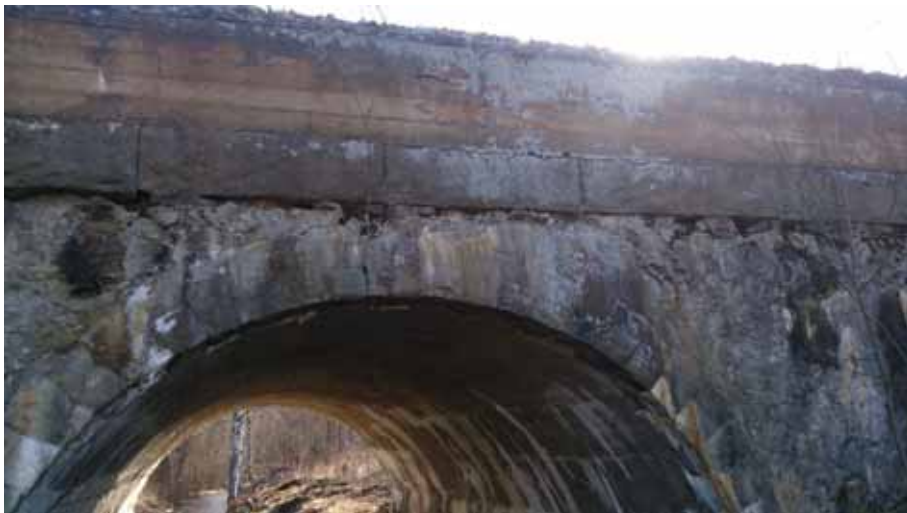
Figur 13. Valvets centrala del på bron västra sida. Foto: Inga Blennå.
