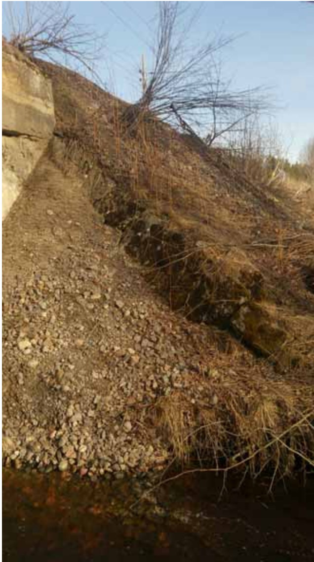
Figur 11. Den stensatta ytan på norra delen av brons östra sida är inte urskiljbar. Foto: Inga Blennå.
