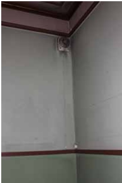
Figur 9. Ämbetsmannarummet före påbörjade arbeten. I en tidigare ventilationsöppning hade under sen tid en fläkt monterats. Foto: Ulrika Olsson, Läns museet Gävleborg, 2016-12-05.
