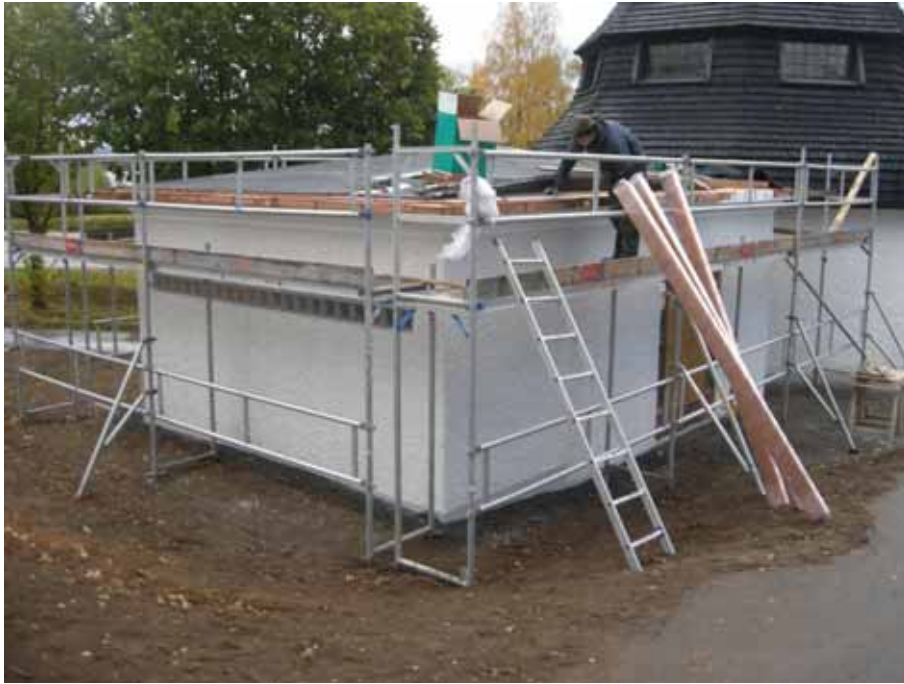
Figur 10. Den norra tillbyggnaden från nordöst under pågående arbete med koppartaket. Foto: Daniel Olsson, Länsmuseet Gävleborg 2015-10-22.
