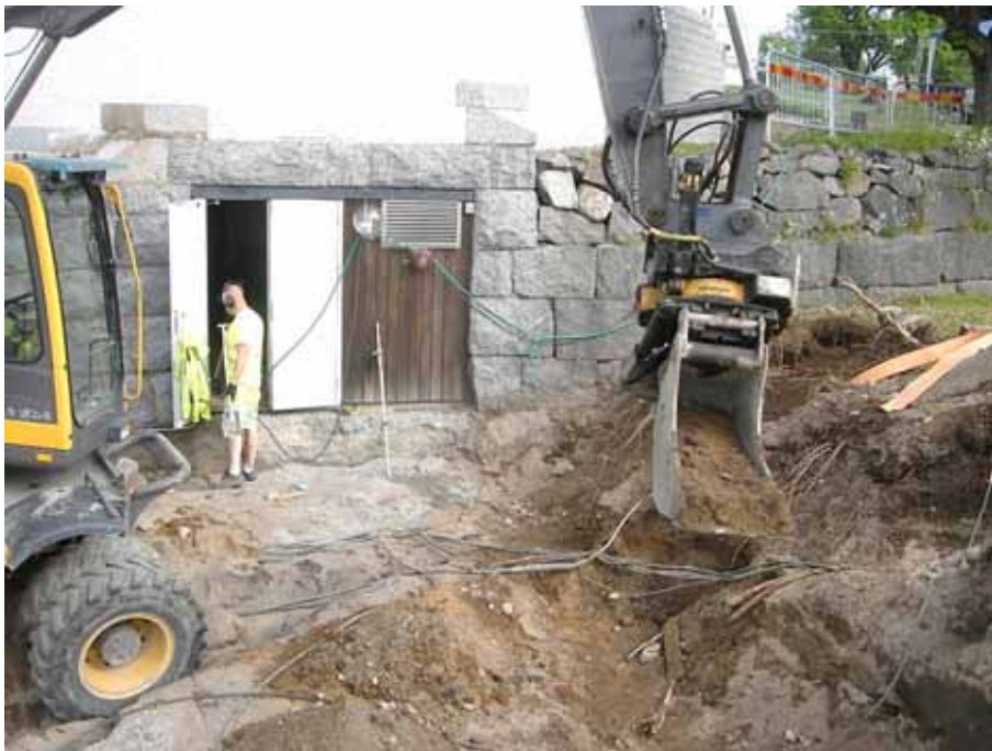
Figur 7. Detalj av grävarbetet öster om kapellet med mängder av ledningar som påträffades i marken. Foto: Daniel Olsson, Länsmuseet Gävleborg 2015-06-01.
