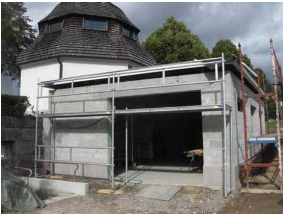
Figur 12. Den sydöstra tillbyggnaden från sydöst under pågående byggarbete. Foto: Daniel Olsson, Länsmuseet Gävleborg 2015-09-23.
