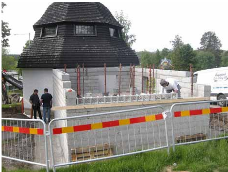
Figur 8. Uppmurning av betongglasraden i gravkapellets norra tillbyggnad. Foto från norr. Foto: Daniel Olsson, Länsmuseet Gävleborg 2015-06-24.
