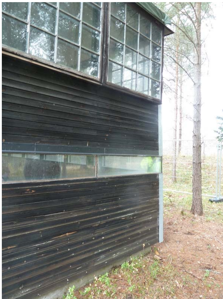
Figur 12. Byggnaden med personalutrymmen innan påbörjad renovering. Här syns plåtinklädnaden av hörnen, vilken tillkommit under modern tid, samt fönsterbågarnas och fönsterbandens eftersatta skick. Foto: 2014-11-24.
