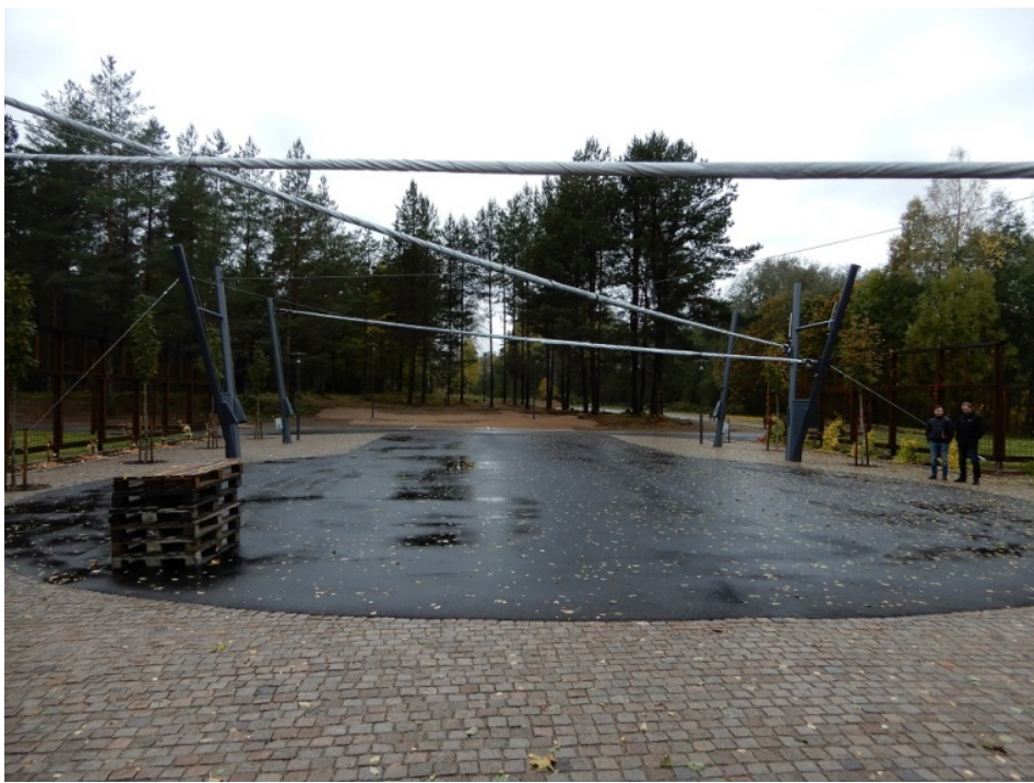
Figur 18. Den asfalterade ytan ska enligt handlingarna beläggas med grusad asfalt, något som ej var gjort vid fototillfället 2017-10-10.
