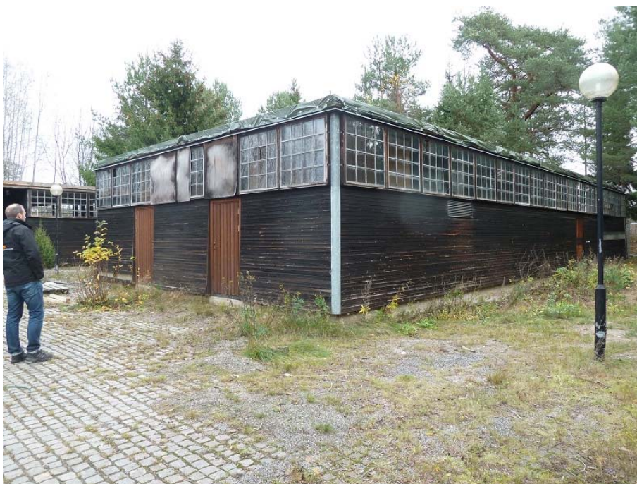
Figur 11. Byggnaden med personalutrymmen innan påbörjad renovering. Takfotens plåtinklädnad i koppar saknades efter en stöld. Byggnadens övriga ytskikt var i stort behov av underhåll. Foto: 2014-11-09.
