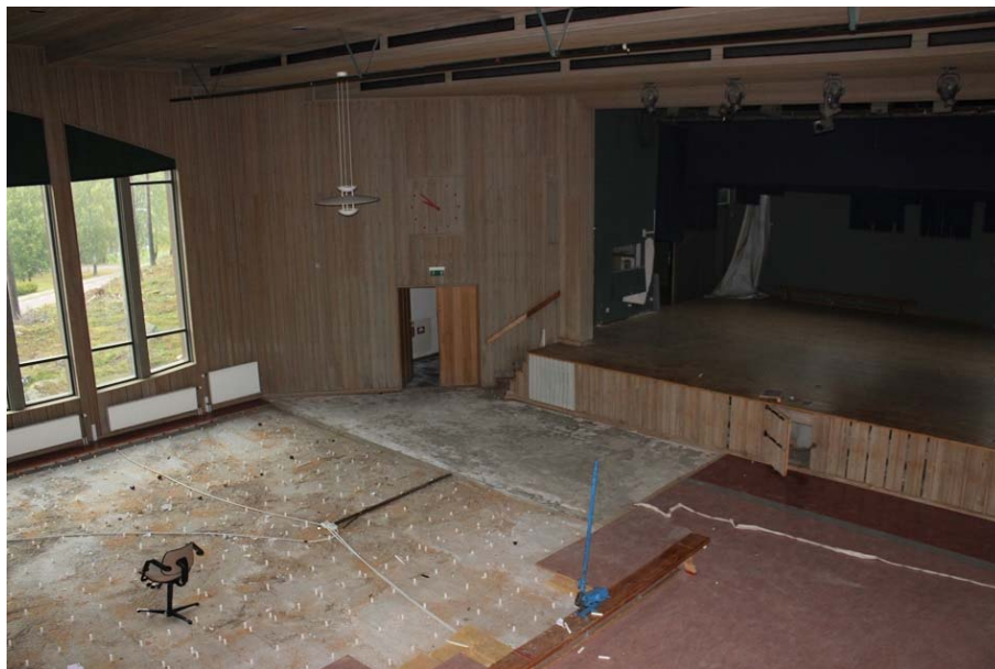
Aulan och scenen sedd från den senare tillkomna våningen i rummet. Golvet är uppbrutet på grund av en tidigare vattenskada. Foto: 2017-09-22.
