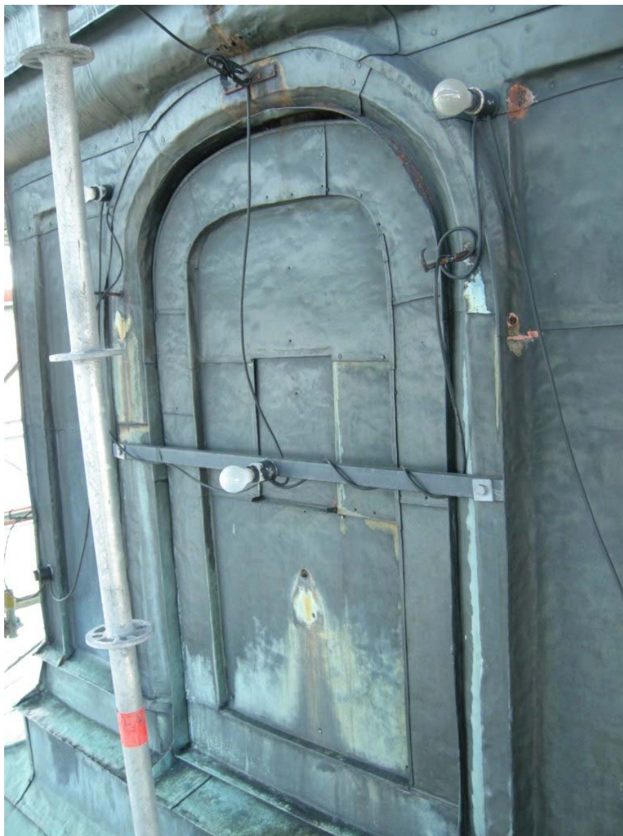
Figur 9. Detalj av de tidigare belysningsarmaturerna med tillhörande lösa kablar i höjd med tornets nedre rad med luckor. Foto: Daniel Olsson, Läns-museet Gävleborg 2009-05-26.
