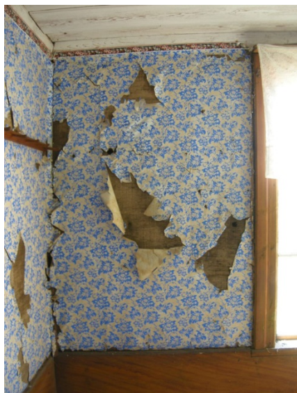
Figur 9. Skadade tapeter i den nordvästra kammaren innan renoveringen påbörjades. Foto: Daniel Olsson, Läns museet Gävleborg 2011-05-31.
