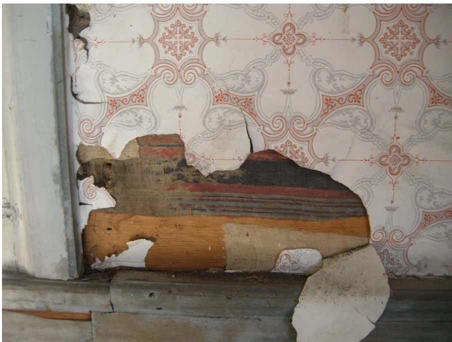
Figur 11. Detalj av skada i tapeten från 1840-talet i den övre salen. Jämför med fotot på rapportens framsida. Tygremсор har använts för att få en jämn övergång mellan de bilade timmerstockarna som underlag åt tapeten. Foto från väster. Foto: Daniel Olsson, Läns museet Gävleborg 2009-05-15.
