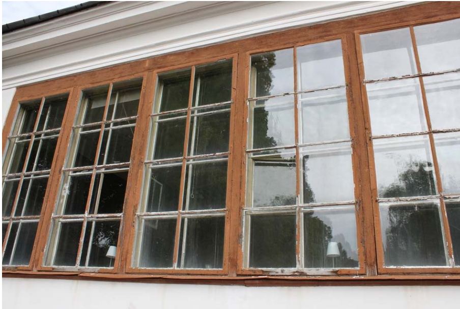
Figur 4. Underhållet av orangeriets fönsterpartier var mycket eftersatt. Färgen flagade, kitt saknades och flera trädelar var uttorkade och uttjänta. Här anas de två vädringsrutorna på innerbågarna i fönsterbandets mitt. Dessa finns kvar, medan vädringsrutorna i ytterbågarna har tagits bort. Foto: Ulrika Olsson, Läns museet Gävleborg, 2017-06-29.
