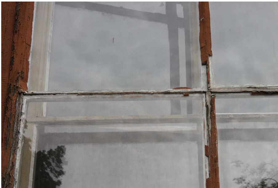
Figur 5. Vissa glas satt mycket dåligt på grund av dåligt trä och avsaknad av kitt. Foto: Ulrika Olsson, Läns museet Gävleborg 2017-06-29.
