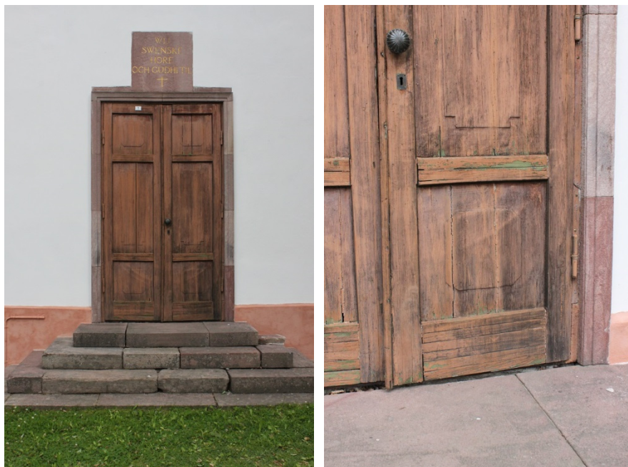
Figur 6 och 7. Entréporten på den västra gaveln innan påbörjade arbeten. Nederdelen på karmen var upprötad vilket påverkade dörrens upphängning. Dörrbladens delar hade spruckit isär. Färgen flagade kraftigt. Foto: Ulrika Olsson, Läns museet Gävleborg 2017-06-29.
