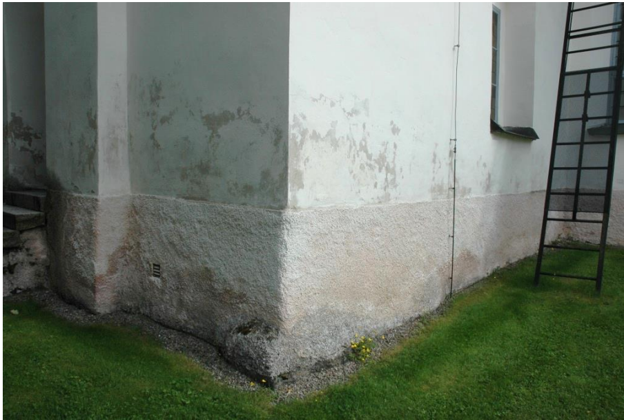
Figur 6. Detalj av flagnande färg och putssläpp på tornets fasad och grund vid hörn mot nordväst. Foto: Daniel Olsson, Läns museet Gävleborg 2016-06-15.
