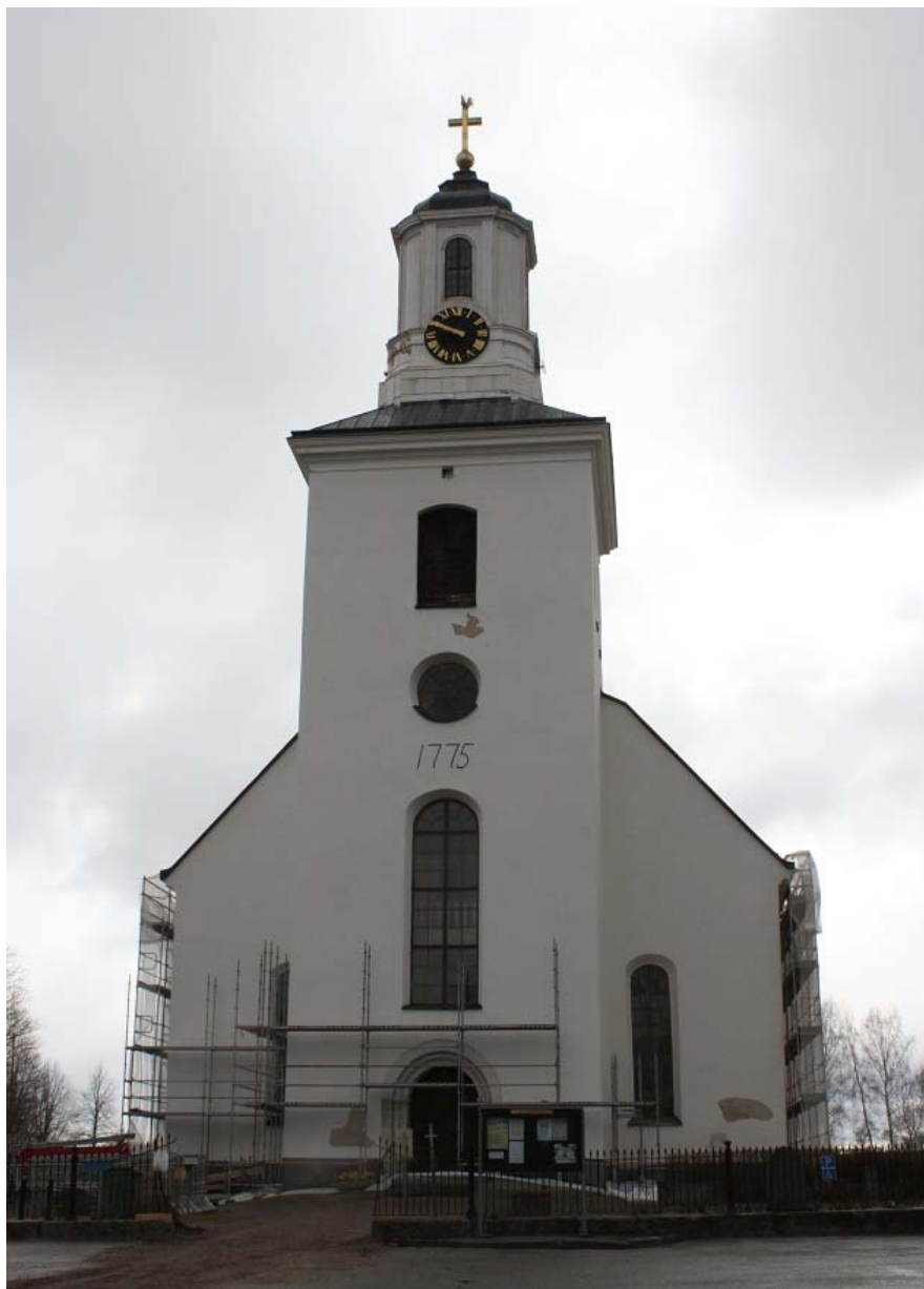
Figur 10. Hedesunda kyrka före påbörjade arbeten. Putsskador syns vid tornluckan samt längst ner på både långhus och torn. Foto: Ulrika Olsson, Läns museet Gävleborg, 2017-04-26.
