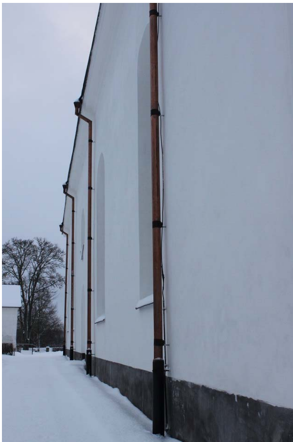
Figur 17. Stuprör med utkastare på långhusets norra sida. Samtliga stuprör byttes till nya inom detta projekt. Foto: Ulrika Olsson, Läns museet Gävleborg, 2018-01-24.
