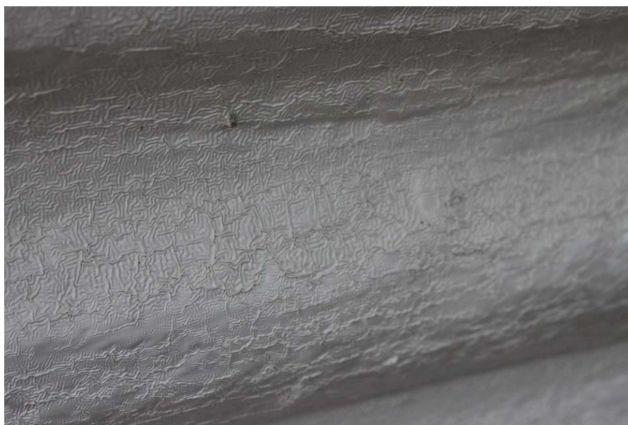
Figur 23. Skrynklad färg på trädelar på tornet. Foto: Ulrika Olsson, Läns museet Gävleborg, 2017-09-19.
