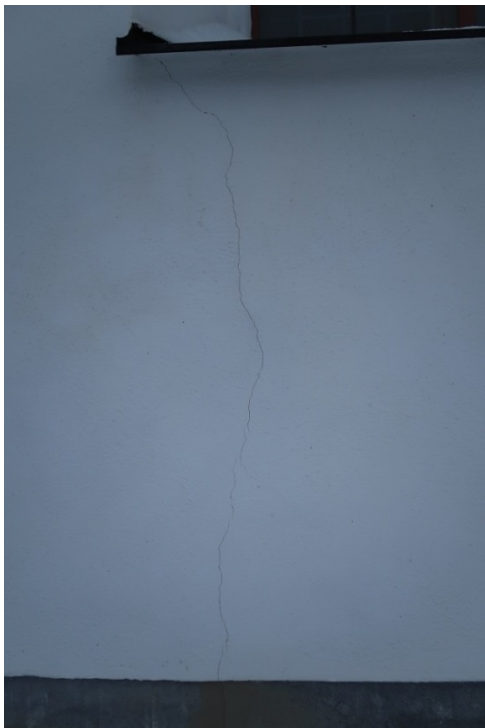
Figur 25. Spricka i putsen på långhusets södra sida. Foto: Ulrika Olsson, Läns museet Gävleborg, 2018-01-24.
