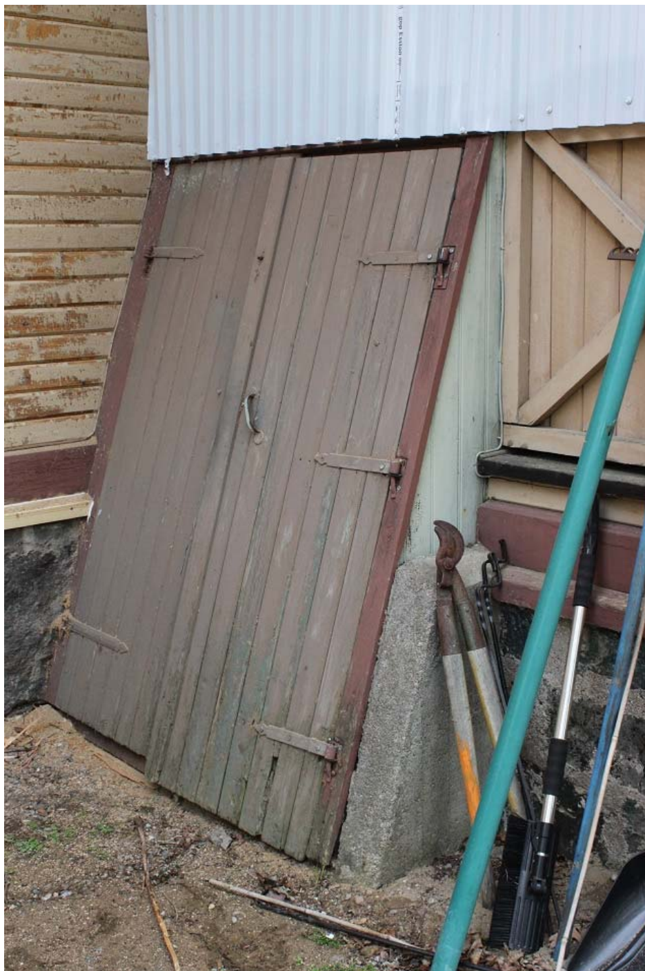
Figur 10. Källarporten invid verandan, var uttjänt. En ny har tillverkats under projektet. Foto: Ulrika Olsson, Länsmuseum Gävleborg, 2017-05-31.
