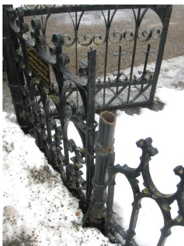
Figur 13. Detalj av skadad staketstolpe. Foto: Daniel Olsson, Läns museet Gävleborg 2017-03-14.
