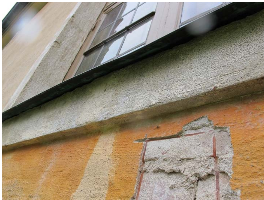
Figur 6. Exempel på hur den gamla putsens kulör kunde variera beroende på läge på fasaden, 2014-06-23. Foto: David Pettersson, Byggekultur.
