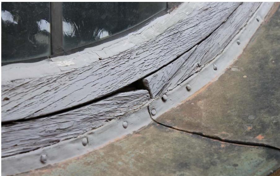
Figur 15. Utlakad färg och skador i fönsterkarm, 2017-04-06. Foto: Ulrika Olsson, Läns museet Gävleborg.
