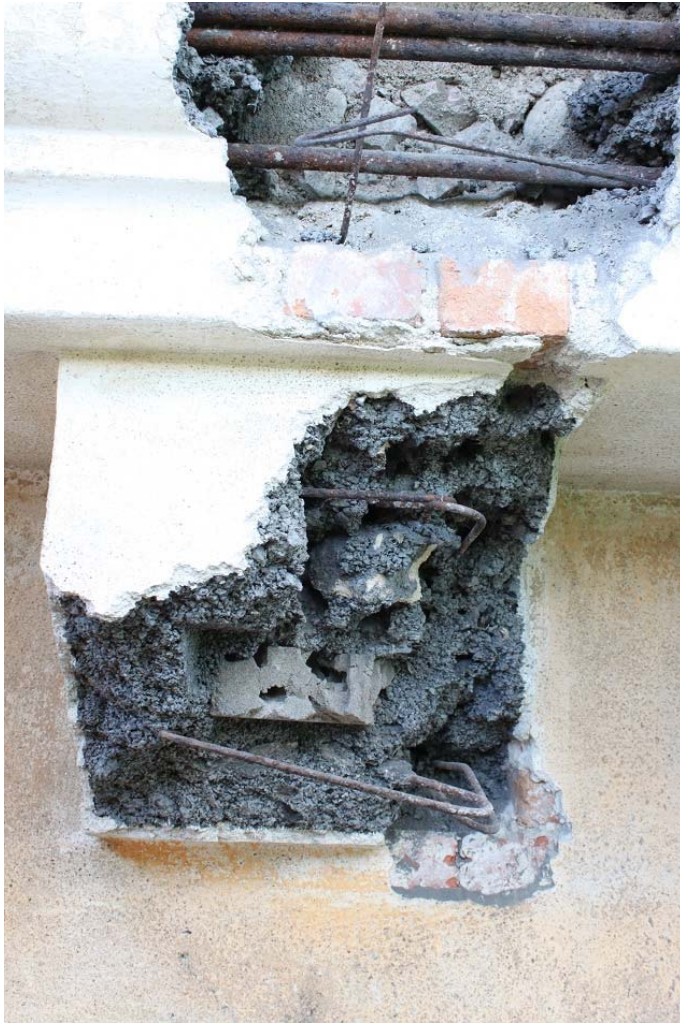
Figur 8. Exempel på skada i en av kuberna i tandsnittsfrisen, 2017-02-07. Skadorna är orsakade av inträngande vatten mellan murverk och plåttak. Foto: Ulrika Olsson, Läns museet Gävleborg.
