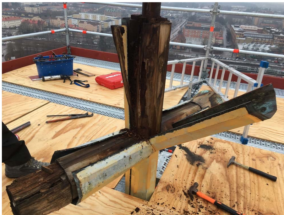
Figur 57. Plåtbeklädnaden öppnades upp från de rötskadade trädelarna, 2017-03-01. Foto: Winther Bygg AB.
