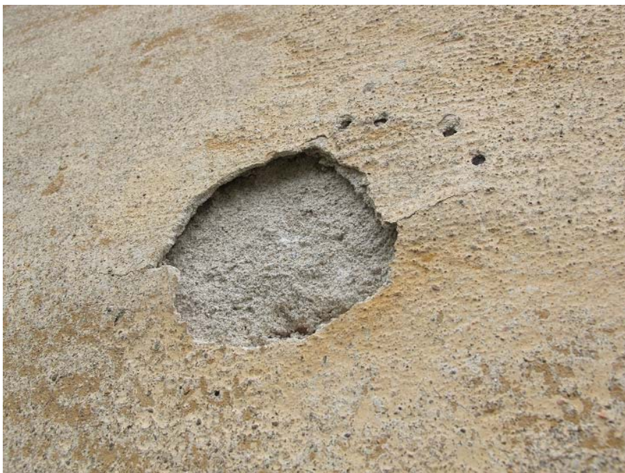
Figur 4. Detalj av frostsprängd putsyta, 2014-06-23. Foto: David Pettersson, Byggkultur.
