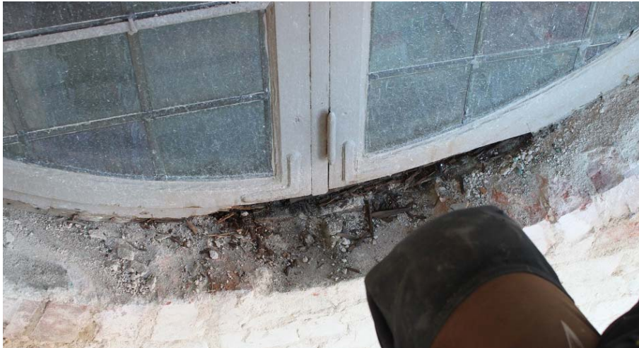
Figur 13. Rötskador i karmen på runda fönstret på tornets östra sida, 2017-03-29. Foto: Ulrika Olsson, Läns museet Gävleborg.
