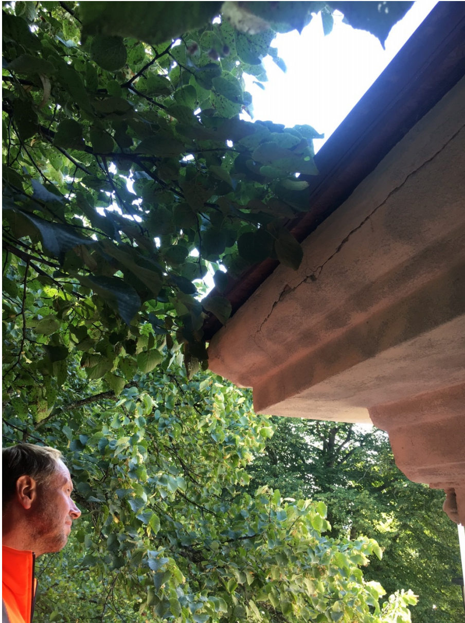
Figur 4. Träden efter Kaplansgatan har kronor som når ut över taket. Detta orsakar mängder av löv i fotrännorna och vattkuporna. Under projektets gång har Gävle kommun beskurit träden en aning. Foto: Ulrika Olsson, Läns museet Gävleborg, 2017-08-28.
