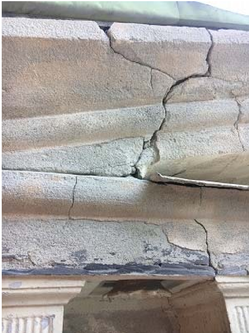
Figur 3. Kraftig sprickbildning i takfoten. Foto: Ulrika Olsson, Läns museet Gävleborg, 2017-08-28.
