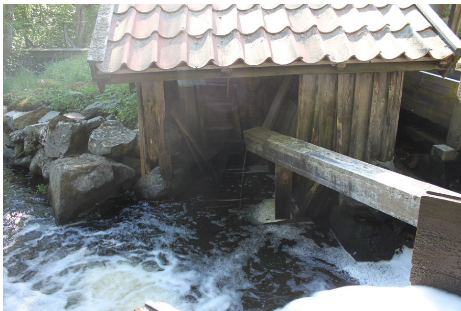
Figur 3. Duschrummet sett från dammen. Hela kortsidan är borta och det högra hörnet hänger fritt utan stabilitet från övrig byggnad. Duschröret har inget fäste i väggen. Foto: Ulrika Olsson, Läns museet Gävleborg, 2018-05-25.
