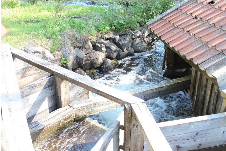
Figur 4. Här syns duschröret som leder från dammen till duschrummet. Detta var uttjänt och hängde fritt i duschen på grund av att hela gavelväggen var borta. Foto: Ulrika Olsson, Läns museet Gävleborg, 2018-05-25.
