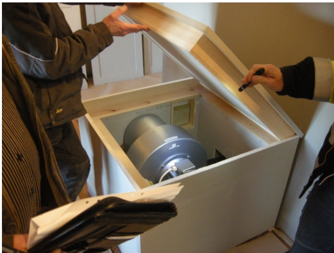
Figur 17. Detalj av den elektriska fläkten placerad i en isolerad trälåda väster om bälghuset. Foto från nordväst. Foto: Daniel Olsson, Länsmuseum Gävleborg 2014-11-26.
