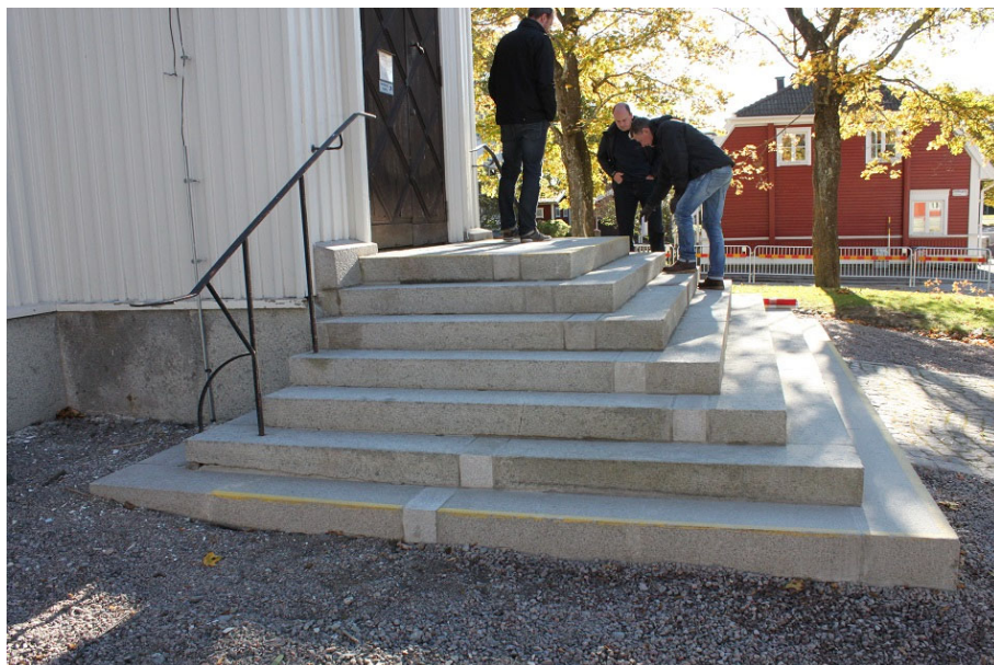
Figur 18. Trappan är omlagd genom mindre stenar som skjutit ut översta vilplanet och vidare ner i trapploppet. 2016-10-03.
