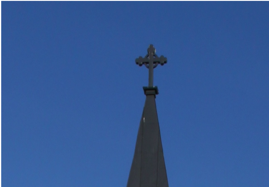
Figur 10. Korset är målat i samma kulör som takplåten, NCS S 800-N. 2018-10-10.
