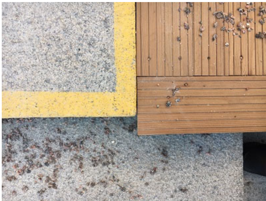
Figur 31. Rampens anslutning mot övre vilplanet, innan montering av räcken. Rampen är byggd efter ritningarna, medan vilplanets djupmått blev kortare än föreskrivet. Det utskjutande hörnet på rampen snedkapades senare. 2016-12-01.
