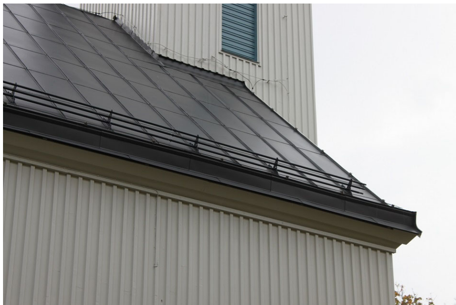
Figur 31. Den luftade takfoten anas under plåten, 2018-09-10.
