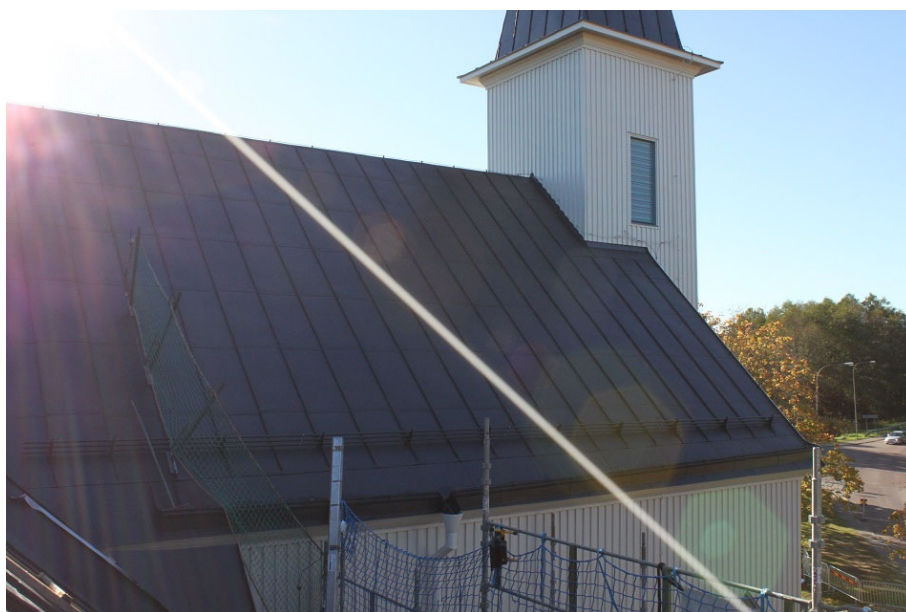
Figur 5. Långhusets norra takfall. Notera ståndskivan mot tornet. 2016-10-03.
