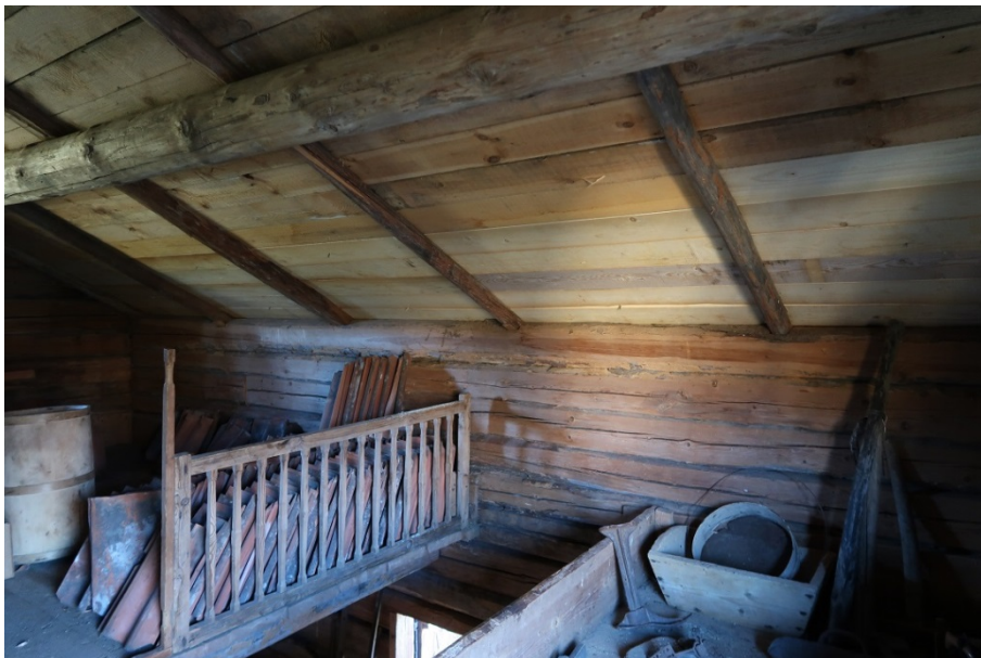
Figur 7. Det södra takfallet inifrån. Takpanelen är utbytt i höjd med mellanåsen. 2018-10-24.
