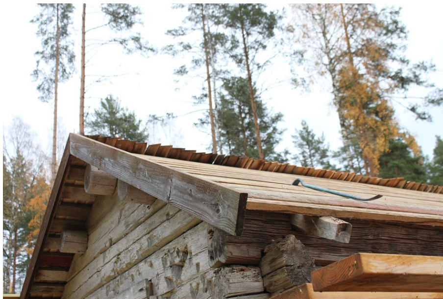
Figur 4. Rötskadad panel är demonterad på den nordligaste belägna boden. Murkna delar fanns framförallt längst ner mot takfötterna på samtliga bodar. 2018-10-17.
