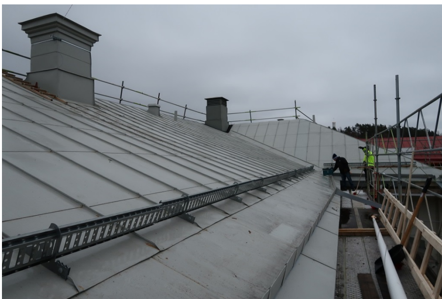
Figur 9. Takfallen vid slutbesiktningen. Foto: 2018-11-30.
