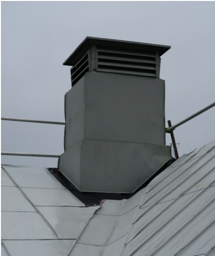
Figur 11. Vid slutbesiktningen saknades ännu beslag på den östra skorstenen, liksom målning av befintlig plåt i samma kulör som omkringliggande nya plåtytor. Foto: 2018-11-30.
