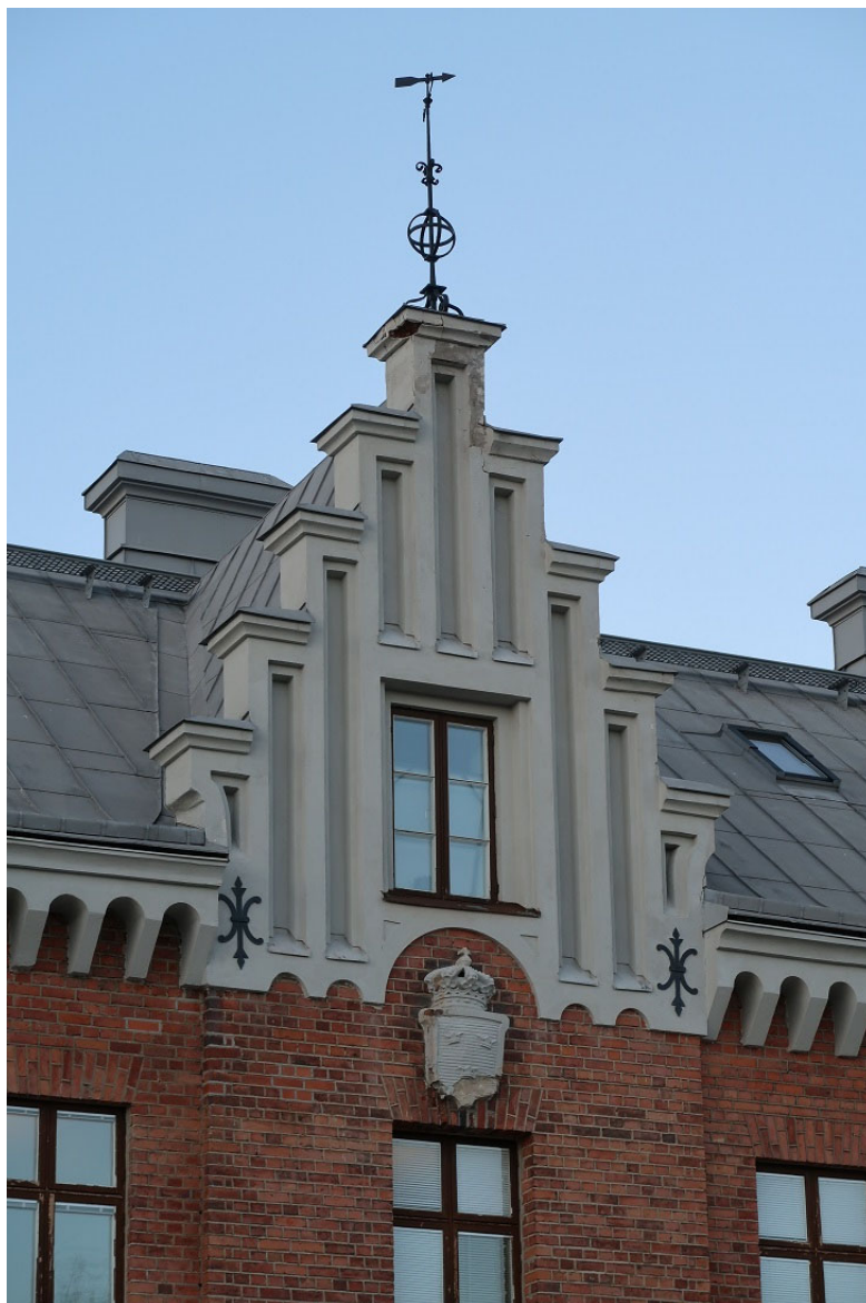
Figur 9. Den södra prydnadsgaveln vid slutbesiktningen. Inga åtgärder är ännu utförda här. Skadorna ska åtgärdas så snart väder och temperatur tillåter under våren 2019. Foto: Ulrika Olsson, Länsmuseet Gävleborg, 2018-11-22.
